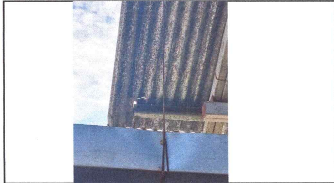
Foto 1 Las láminas del entechado se encuentran con agujeros así también los canales de aguas pluviales.
