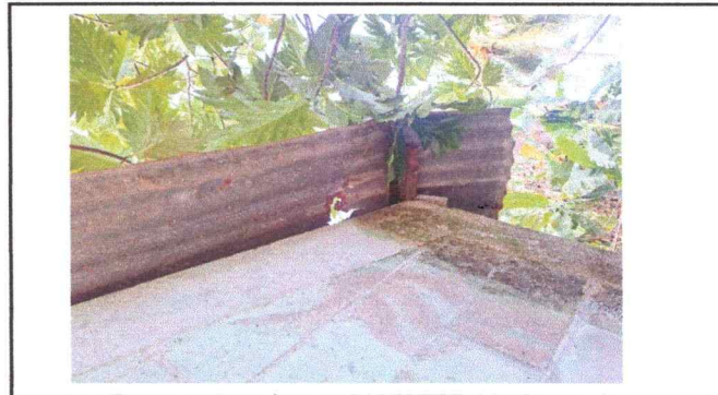
Foto 4 las láminas del entechado de los baños se encuentran con grandes agujeros.
