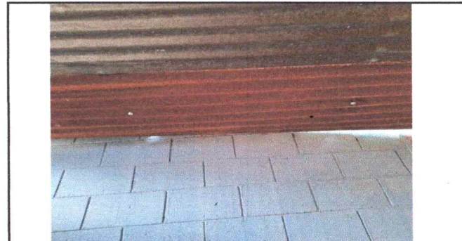
Foto 6 Así se encuentran las láminas del entechado de una de las aulas con agujeros y oxidadas.
